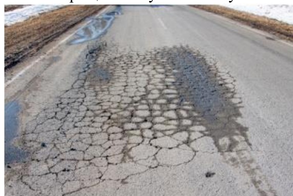
Сетка трещин на пучинистом участке
